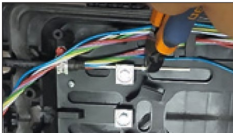
4.1.7 Acomodar los tubos loose que no se usarán en la reserva.
