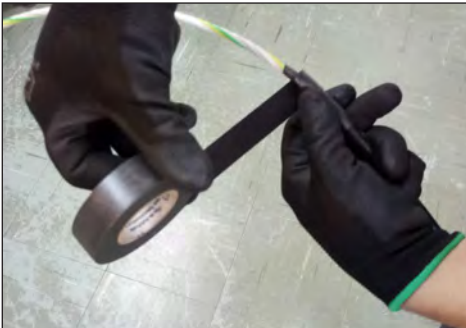
6.2. Se recomienda realizar el acabado del cable óptico con cinta autosoldable o aislante, para protección de los tubos loose.
